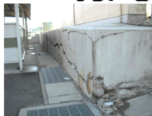
亀裂が入った校舎東側土台
