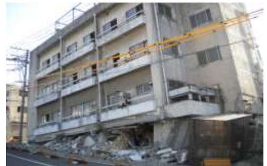
【郡山市内の被害の様子】
