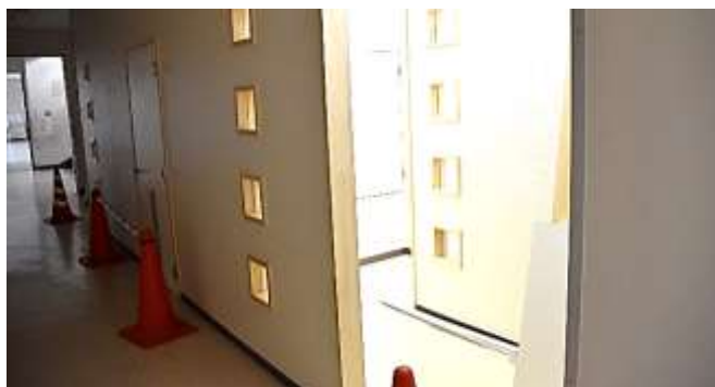
▲ 中校舎のトイレの入り口ができました。現在、トイレ内の設備を設置しています。
