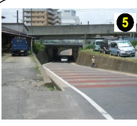
5 ほ道がなく雨のたまるずい道
